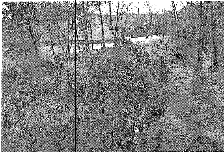
Curs de apă existent ce necesita interventii
